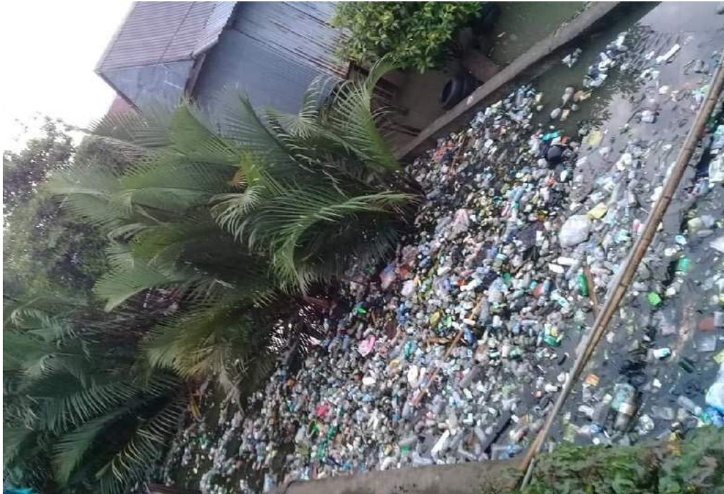
Salah satu gambaran kondisi saluran air di area perkotaan Kecamatan Sinjai Utara yang dipenuhi sampah
